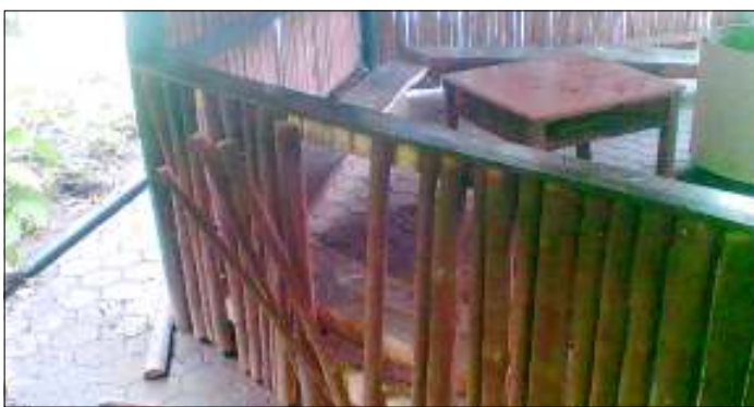
Beschädigungen an der Grillhütte.
