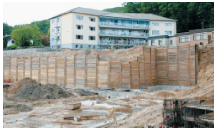
Gute Gegend: Das neue Gebäude für die Wittekindshofer Förderschule entsteht in unmittelbarer Nachbarschaft zum Therapiezentrum. Mit Berliner Verbau ist die Baugrube am Südhang des Wiehengebirges abgesichert. FOTO: ANKE MARHOLDT
