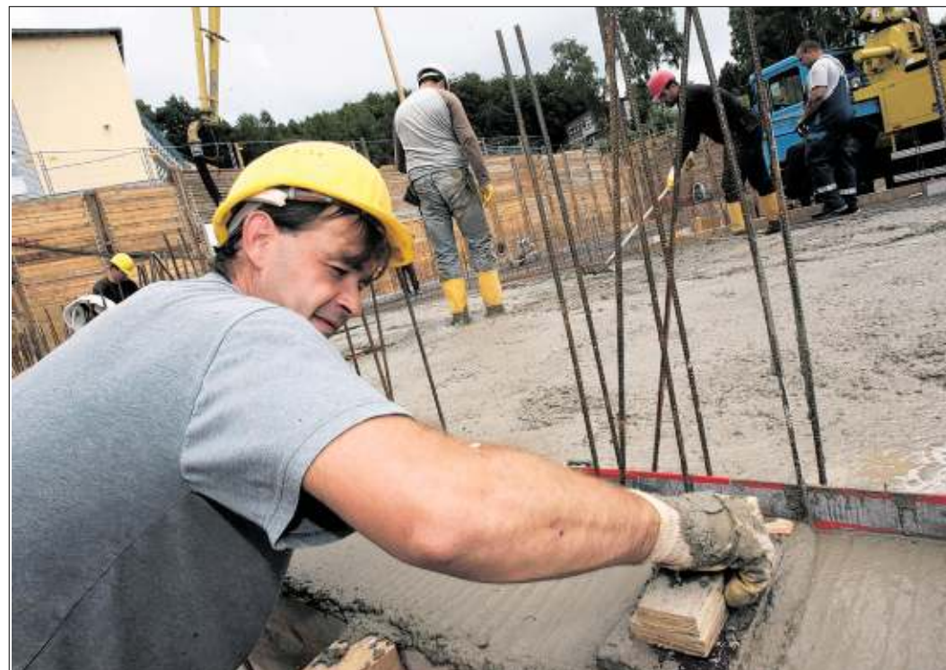
Die ersten Fundamente sind entstanden, am Mittwoch wird der Grundstein für die Wittekindshofer Förderschule gelegt.
